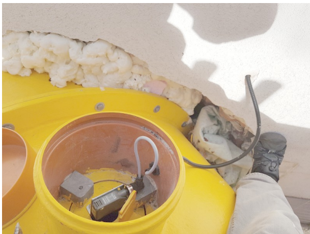
Obr. 1: Montáž difusního čidla do připravené kobky na horní straně uzavřeného tubusu toboganu
